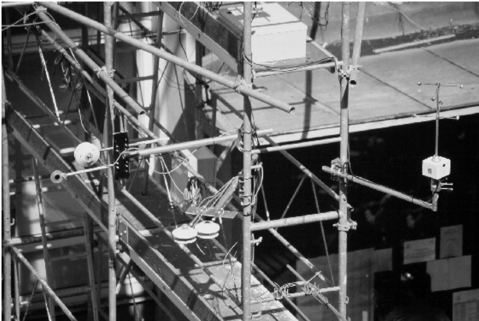
Figure 3 : Photographie de quelques instruments installés sur l'échafaudage. On y voit notamment un anémomètre sonore, un bilan-mètre... Photograph of some of the measurement devices on the scaffolding.
